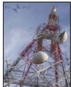
IMPIANTO DI TRASMISSIONE
